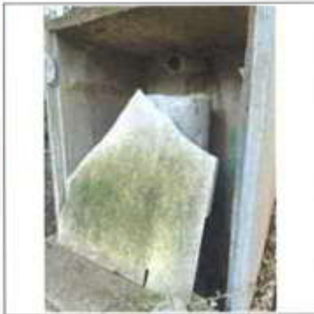
Photo n° PhA003 Localisation : Rez de jardin - Abris de jardin; Parties extérieures, Regard eau Ouvrage : 2 - Parois verticales extérieures et Façades - Façades légères, murs rideaux, bardages, panneaux sandwich Partie d'ouvrage : Plaques Description : Plaques
