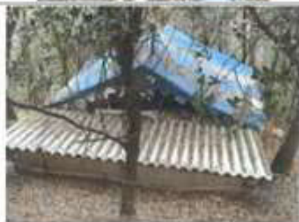
Photo n° PhA002 Localisation : Rez de jardin - Abris de jardin Ouvrage : 1 - Couvertures, Toitures, Terrasses et étanchéités - Plaques ondulées et planes Partie d'ouvrage : Plaques en fibres-ciment (y compris plaques « sous tuiles ») Description : Plaques en fibres-ciment (y compris plaques « sous tuiles »)
