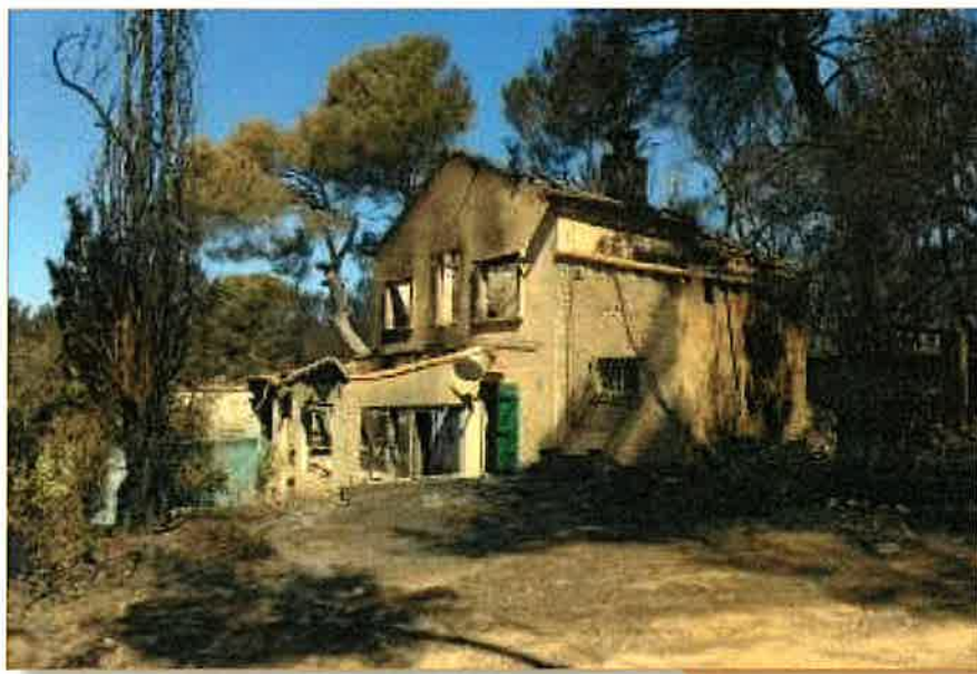
Maison non débrousaillée partiellement détruite par le passage d'un feu, Rognac (13) - source : ONF
