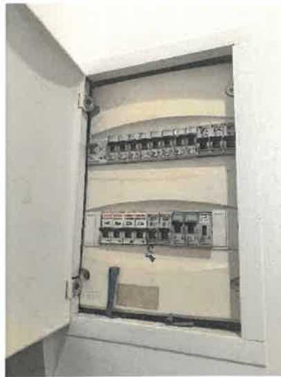
B.4.3 f2) : Impossible de démonter le second tableau sans détruire le BA13 Observation : Démontage impossible sans casser le coffrage
